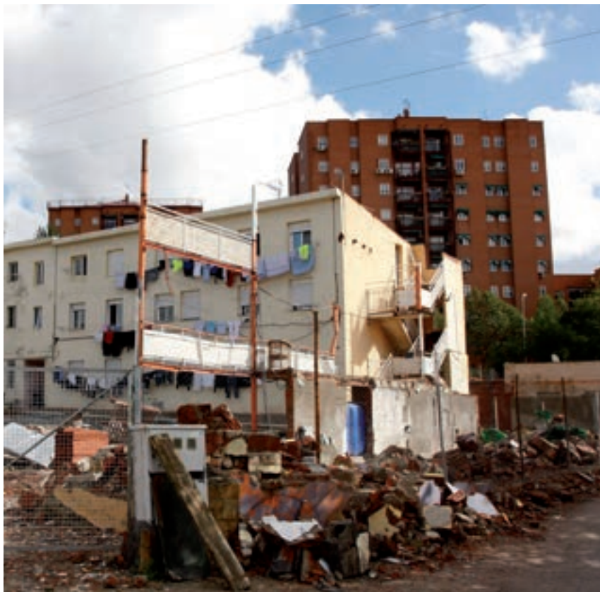
Vertederos y viviendas construidas ilegalmente son parte del paisaje de la Cañada Real.
