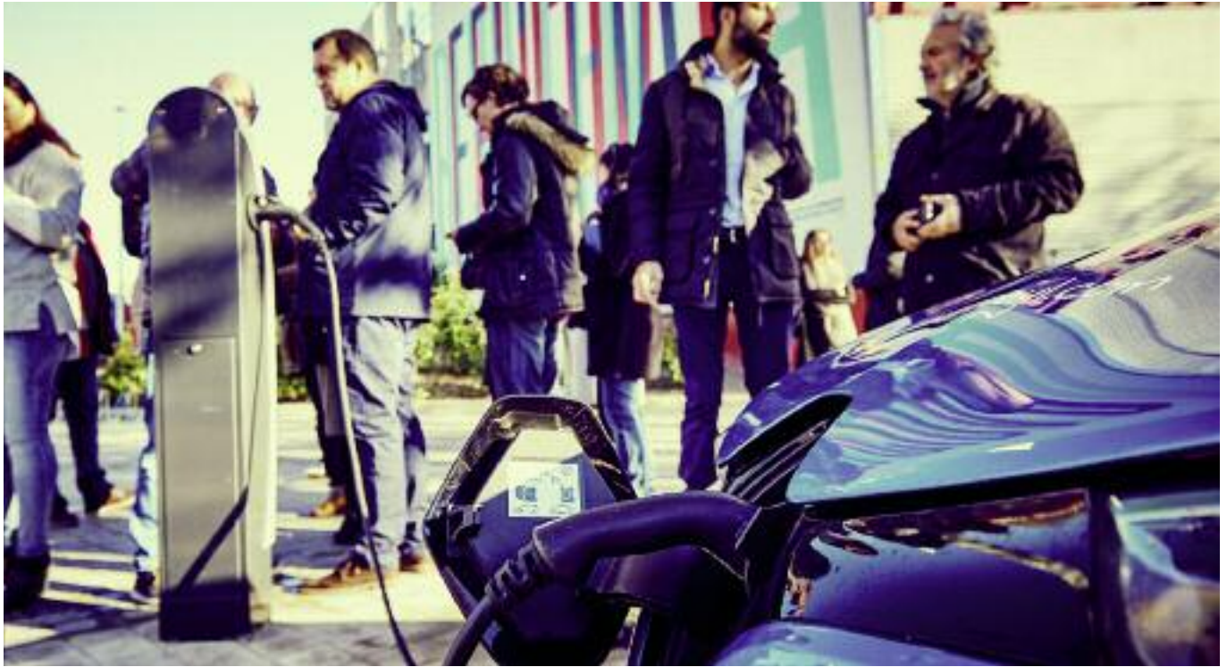
Nuevo punto de recarga de coche eléctrico, frente a la nueva biblioteca Gloria Fuertes. L.G.C.
