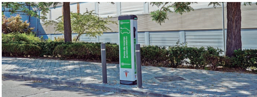
Uno de los nuevos cinco puntos de recarga para vehículos eléctricos instalados en el municipio.
