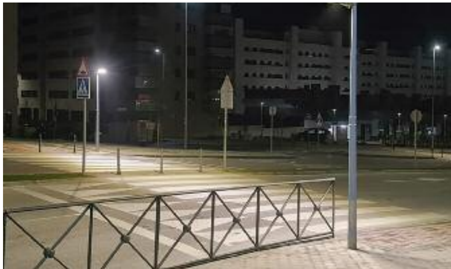
Un paso de peatones iluminado con el nuevo sistema inteligente y luces LED.
