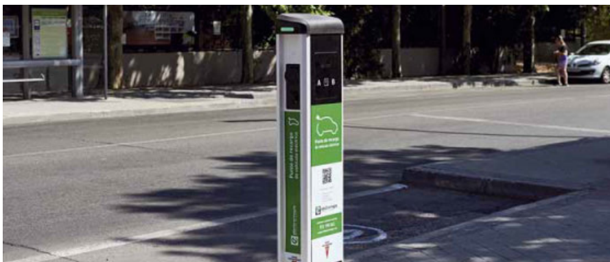
Uno de los 23 postes de recarga para vehículos eléctricos en Rivas. LUIS G. CRAUS
