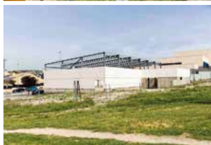
Obras pendientes, después de años de espera: arriba, colegio Mercedes Vera (Hispanidad); abajo, pabellón deportivo del CEIPSO La Luna.
